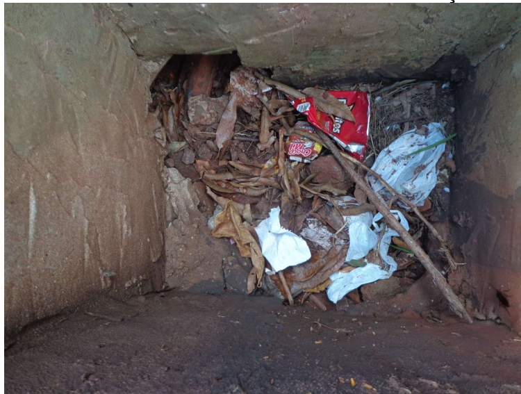
Figura 33: Resíduos sólidos encontrados antes da instalação do cesto coletor.
