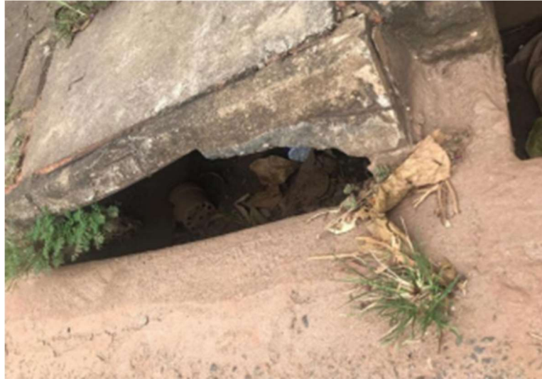
Figura 1: Resíduos sólidos no interior do bueiro.
