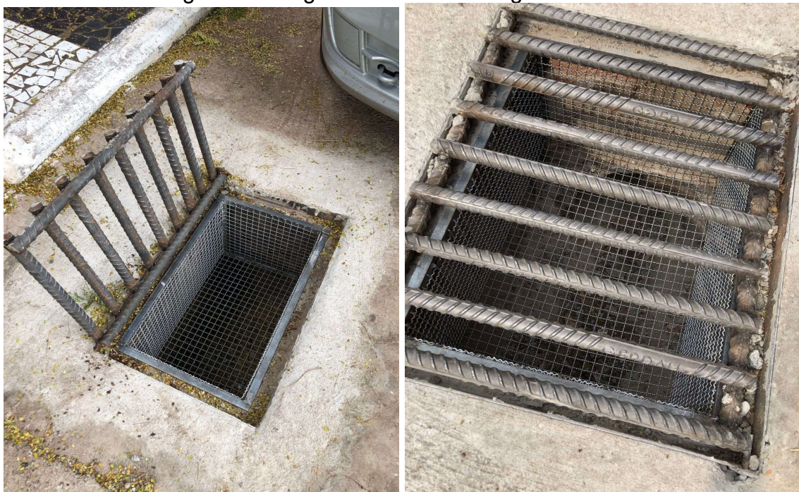
Figura 31 e Figura 32: Bueiro inteligente instalado.
