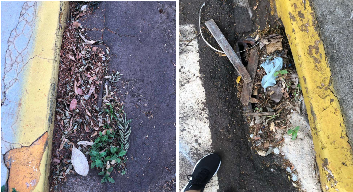
Figura 34 e Figura 35: Resíduos Sólidos nas bocas de lobo.
