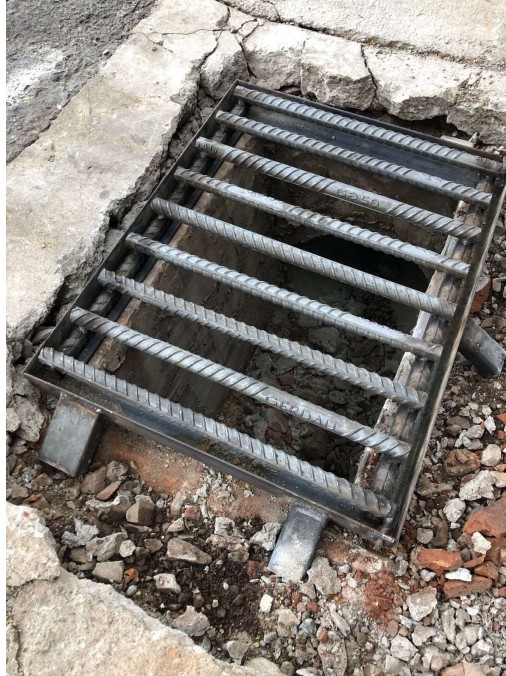
Figura 25: Nova grelha do bueiro inteligente.
