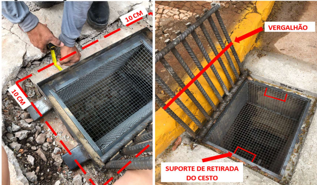
Figura 29 e Figura 30: Recomendações de melhorias após sistema executado.
