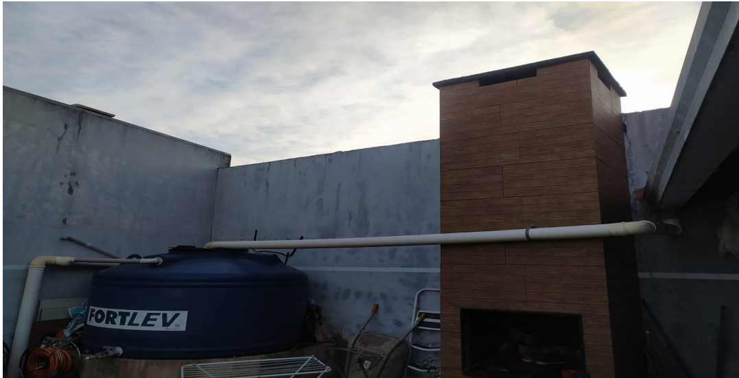
Figura 5: Sistema de captação de água de chuva existente no local.
