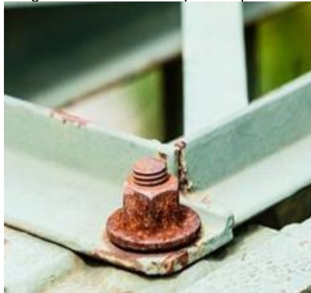
Figura 11: Corrosão de porca e parafuso
