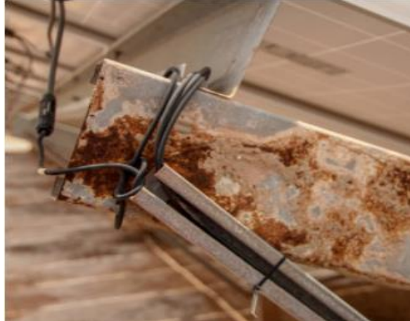
Figura 12: Corrosão de suporte fotovoltaico
